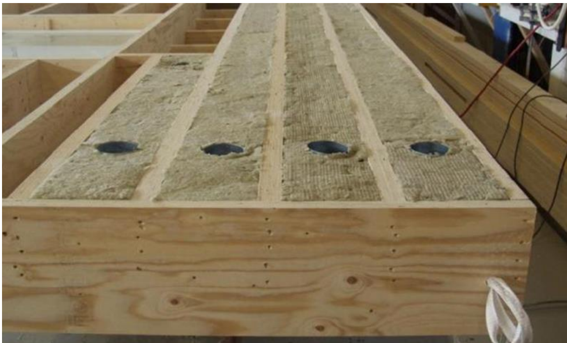
Kuva 11. Ilmanvaihtokanavia TES-elementissä [72, s. 19].
