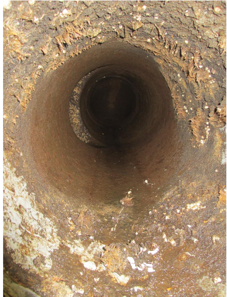
Loviisan voimalaitos, LO1, merivesipumpun imulinja
