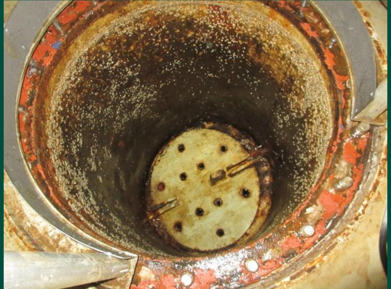
Loviisan voimalaitos, LO1 merivesipumpun imuputki/nielu, merirokkoa
