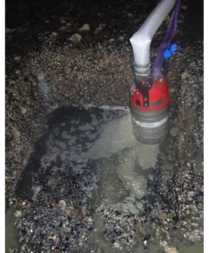
Olkiluodon voimalaitos, OL3 merivesitunneli, pääasiassa simpukoita ja sammaleläimiä
