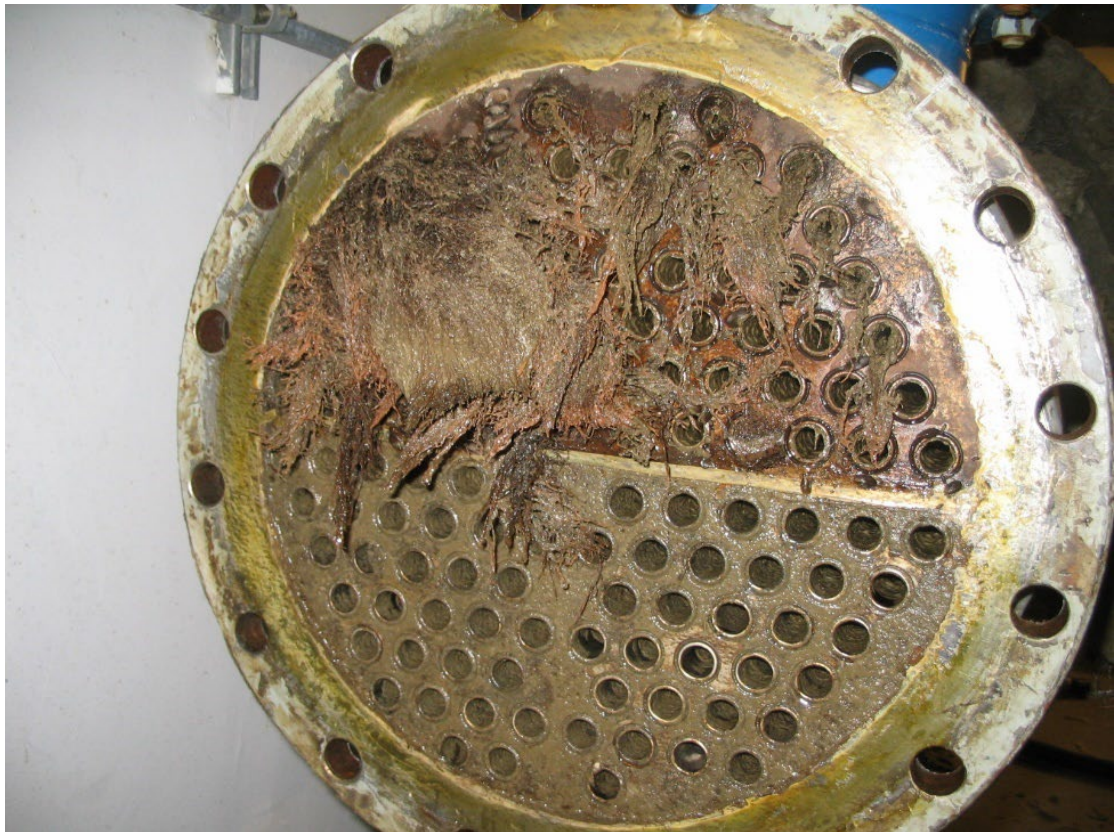
Kuva 6-10. Kaspiapolyypikasvustoa lämmönsiirtimessä (Kuva: Teollisuuden Voima Oyj).
