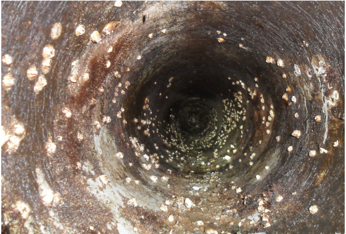
Kuva 6-6. Merirokkoa Loviisan voimalaitoksen merivesijärjestelmän putkessa.
