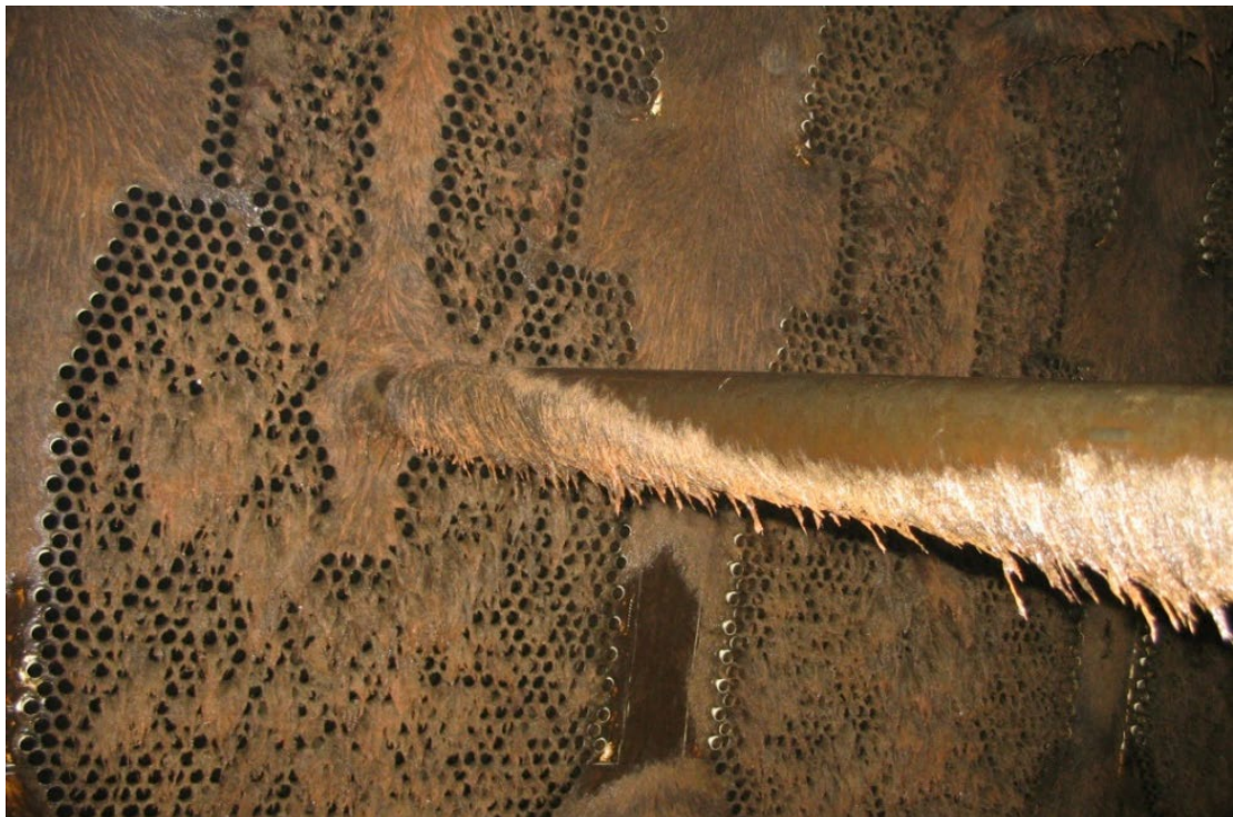
Kuva 6-9. Kaspianpolyyppikasvustoa lämmönsiirtimessä (Kuva: Teollisuuden Voima Oyj).
