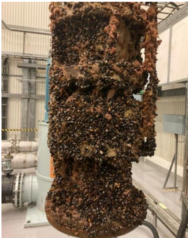
Kuva 6-13. Sinisimpukoita ja merilevää kiinnittyneenä jäähdytysvesipumppuun (Kuva: Forsmarks Kraftgrupp AB).
