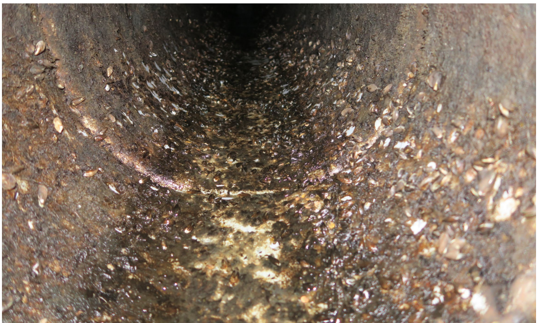
Kuva 6-7. Simpukoita (mahdollisesti rangiasimpukkaa) kertyneenä Loviisan voimalaitoksen merivesijärjestelmän putkessa, jossa vettä ei virtaa jatkuvasti.
