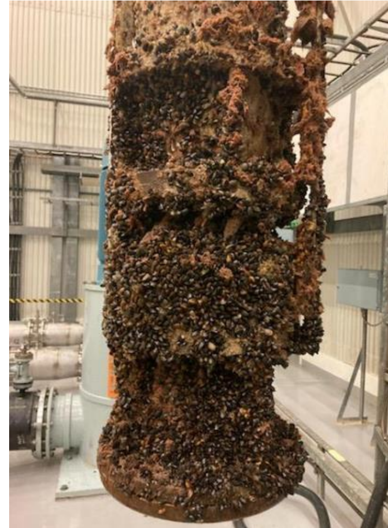
Forsmarkin ydinvoimala: sinisimpukkaa ja merilevää jäähdytysvesipumpussa (mahdollisesti muutakin), kertynyt 5-6 vuodessa
