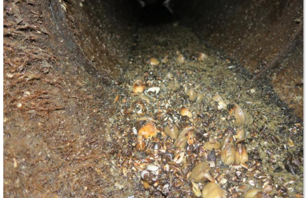
Rangia-simpukkaa 2022 Loviisan voimalaitoksen merivesijärjestelmän putkessa, jossa ei virtaa vettä jatkuvasti
