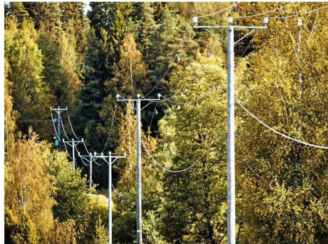
Lintuheijastimia sähkölinjalla. CARUNA
