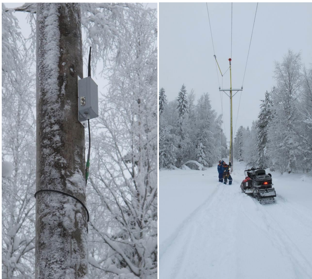
Kuva 2. Keskusyksikkö (vas.) ja lintupallon asennus (oik.)
