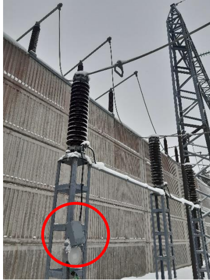
2. Keräin 110 kV siirtolinjan tolpassa
