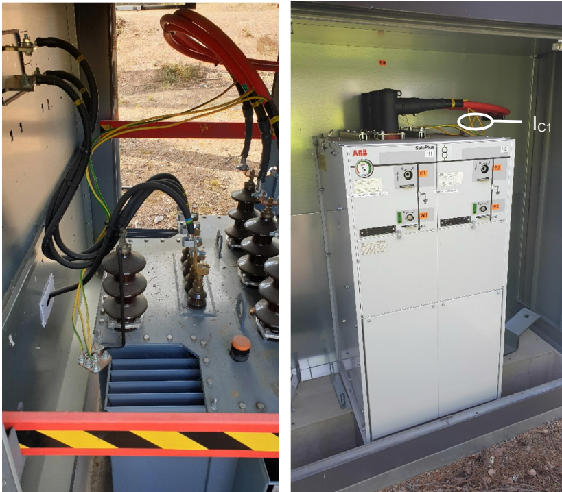
Kuva 5.39 Muuntaja-kojeisto-kaapeleiden kosketussuojien maadoitukset ja niiden virtojen summan mittaus kaapeleiden kojeiston puoleisesta päästä.
