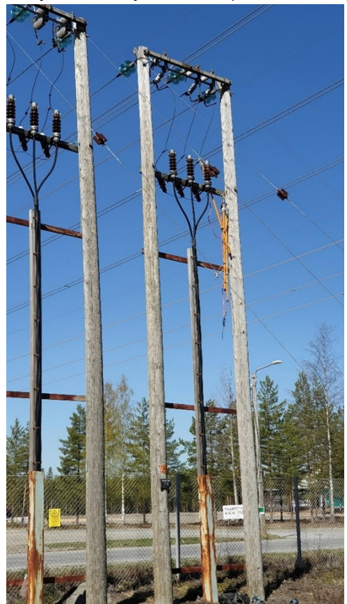
Kuva 5.31 Vikapaikka päätepylvään kaapelipääteellä.
