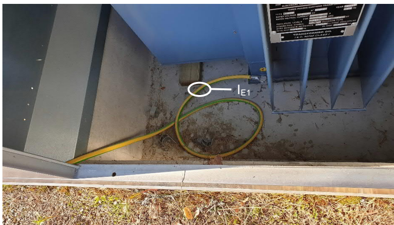
Kuva 5.40 Muuntamon 1 hajautetun kompensoinnin maadoitusjohtimen virtamittaus.
