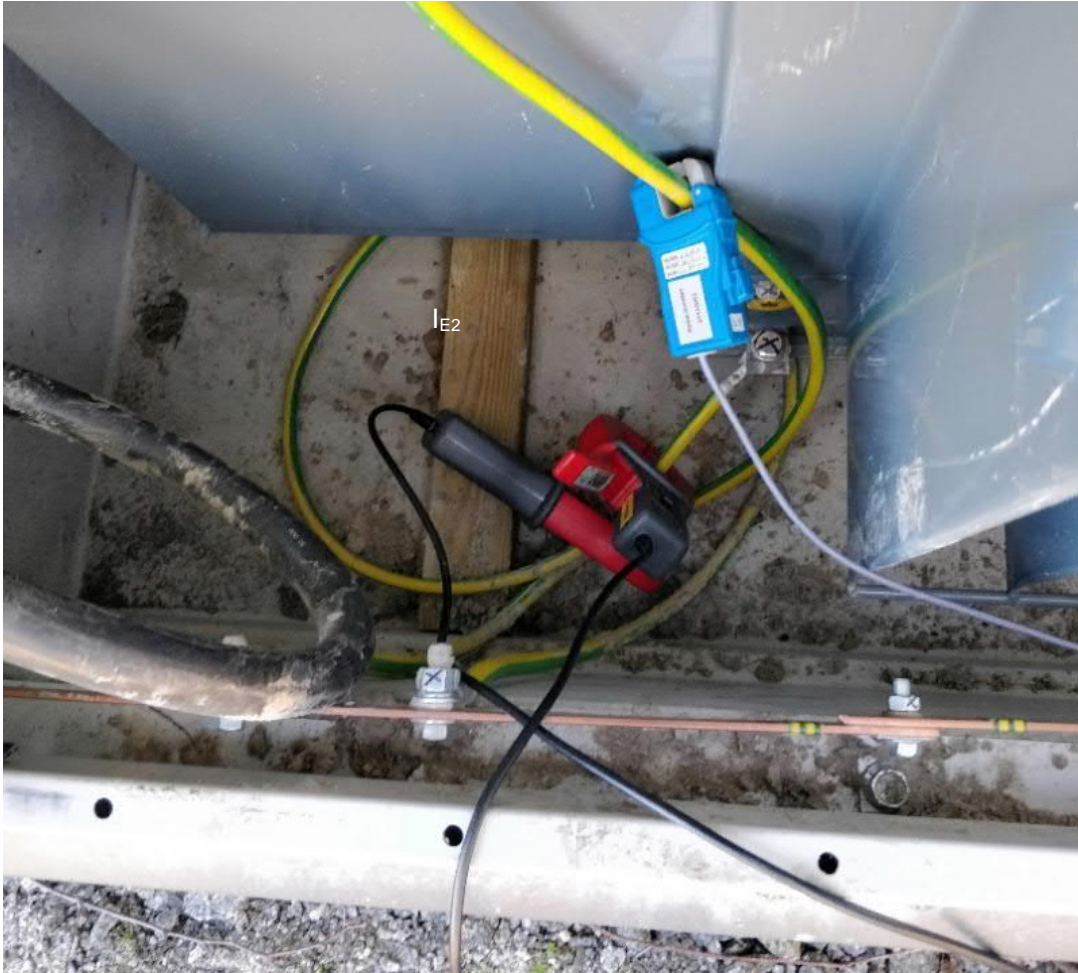
Kuva 5.44 Muuntamon 2 hajautetun kompensoinnin maadoitusjohtimen virtamittaus (keskimmäinen virtapihti). Lisäksi mitattiin myös erillistä muuntajan kannen maadoitusjohtimen virtaa ja näiden kahden virran summaa. Mittausten perusteella muuntajan kannen maadoitusjohtimen liitos muuntajan kannella ei ilmeisesti ollut johtava, koska kaikki virta kulki muuntajan pohjan maadoitusjohtimen kautta.
