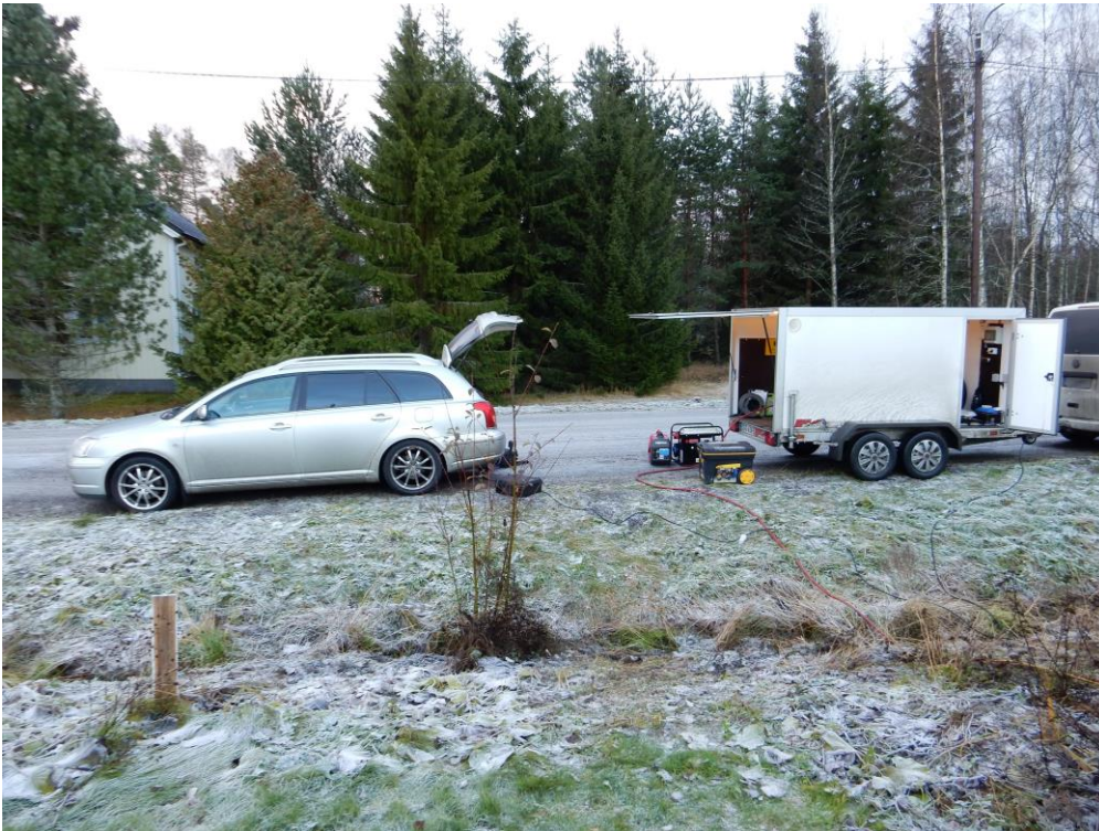
Kuva 7.33. Peräkärryyn asennettu off-line-osittaispurkausmittauslaitteisto (kuvassa oikealla).
