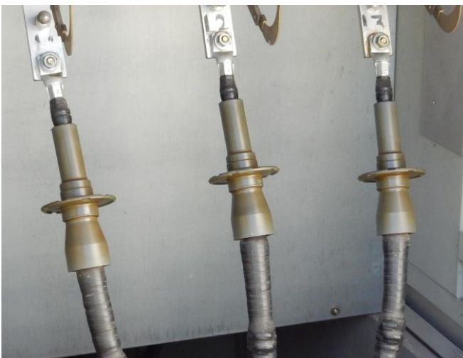
Kuva 2.10. Esivalmistetut 20 kV kaapelipäätteet (ABB Kabeldon).
