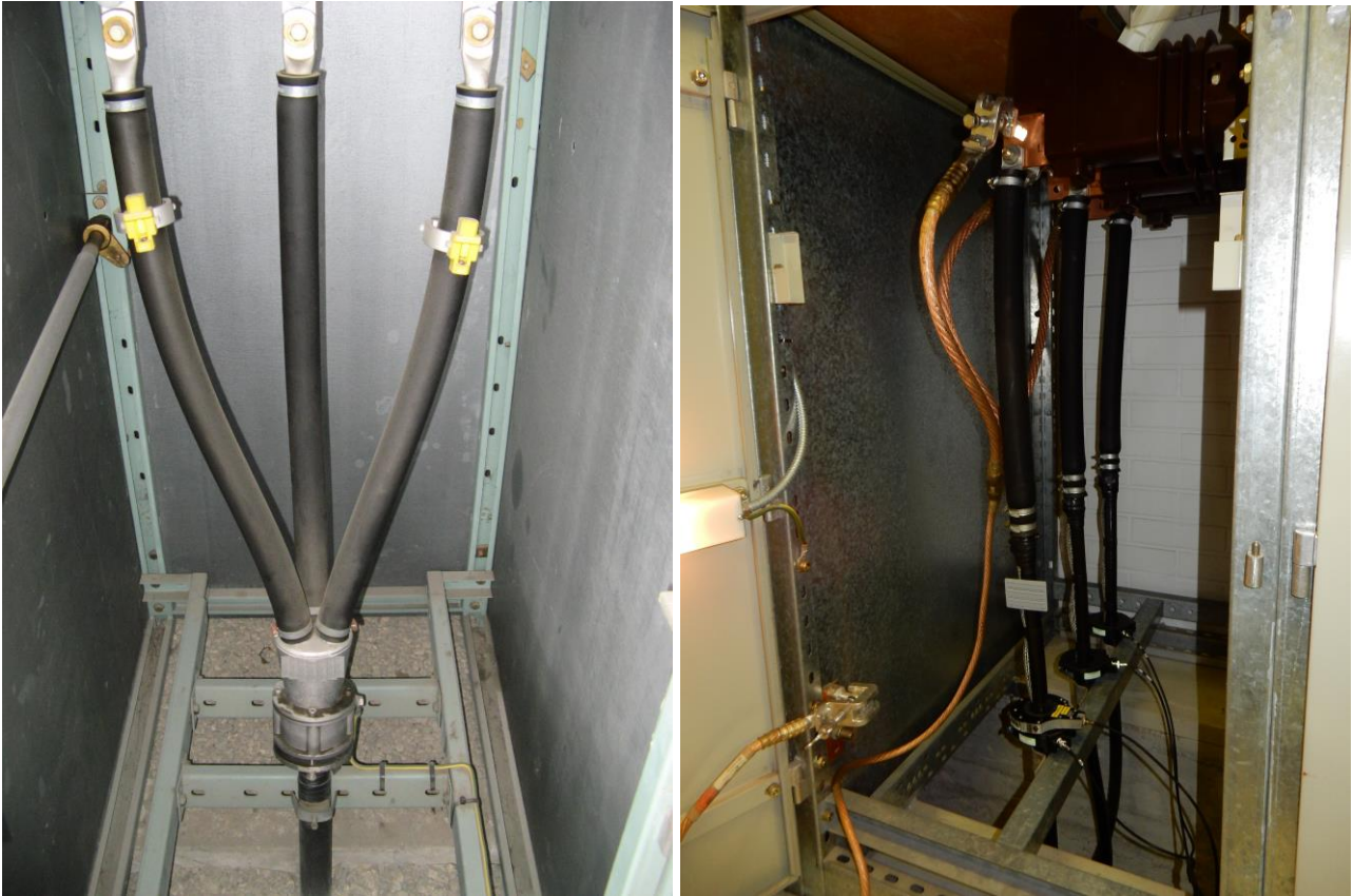
Kuva 2.9. 10 kV letkupäätteitä. Oikeanpuoleinen asennustapa mahdollistaa on-line-osittaispurkausmittaukset HFCT-antureilla, kun vaihejohtimet ovat kosketussuojatulta osuudeltaan riittävän etäällä toisistaan.
