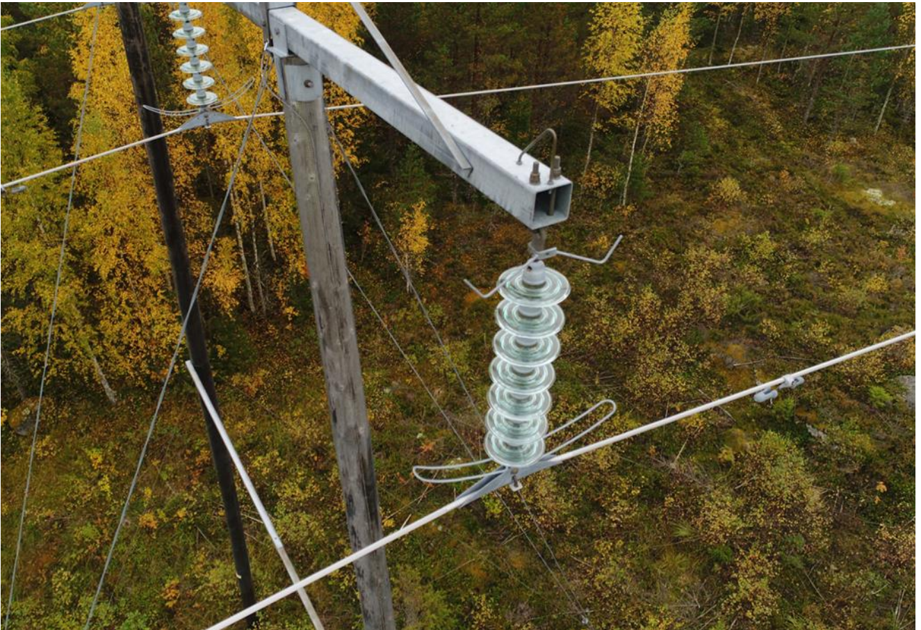
Kuva 8. 110 kV:n eristin multikopterista kuvattuna
