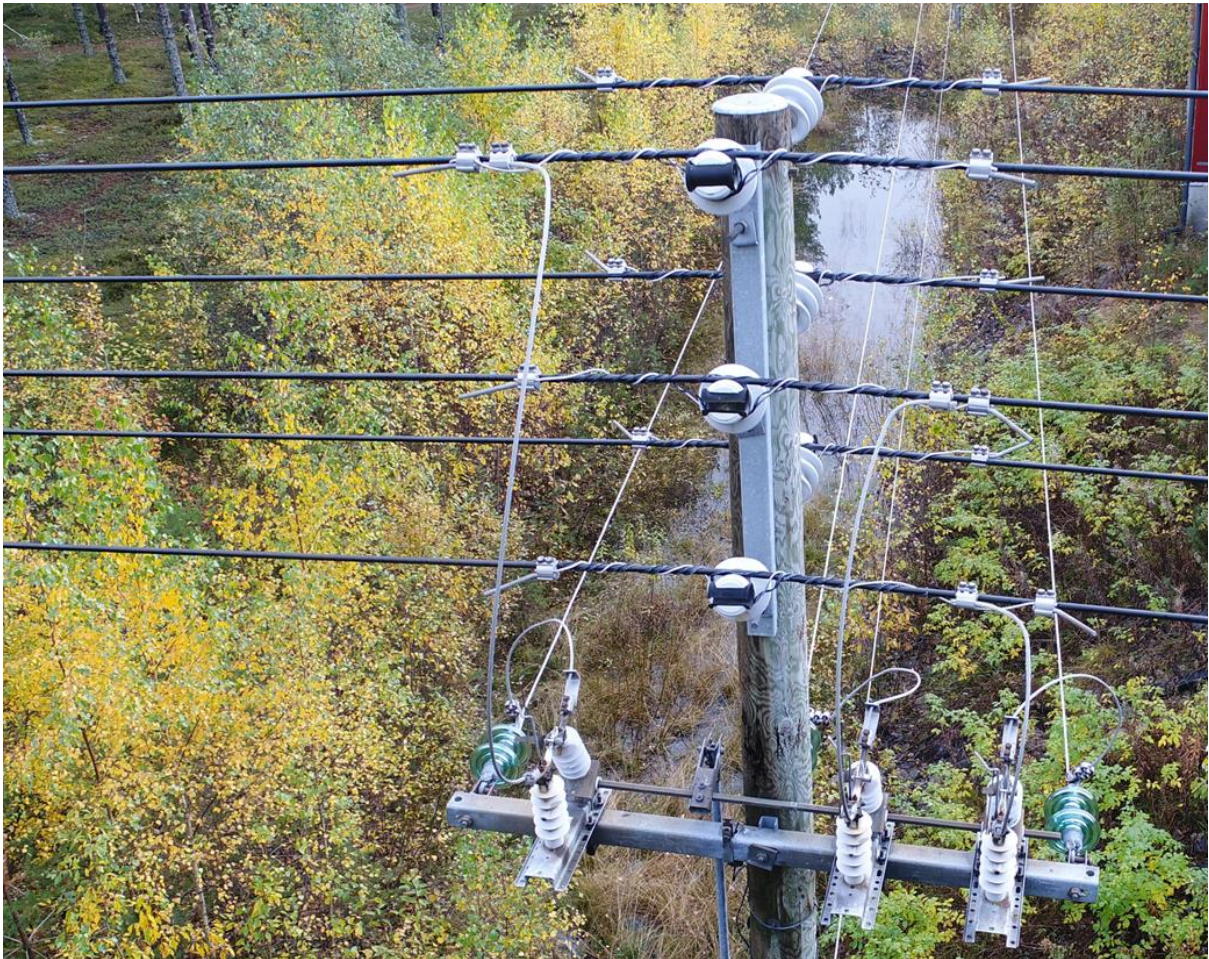
Kuva 10. Pylväserotin 20 kV:n haarapylväässä
