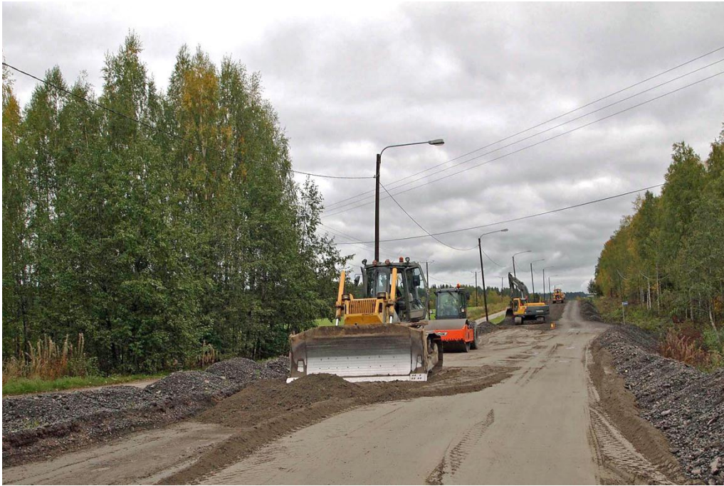
Kuva 13.1 Lentotuhkan levitys ja tiivistäminen käynnissä. Kuvassa oikeanpuoleinen kaista on jo tiivistetty ja kevyessä liikennekäytössä. Sivuilla näkyvät murskekasat toimivat tiivistystukena. (Kuva: Olli Kiviniemi, Ramboll)
