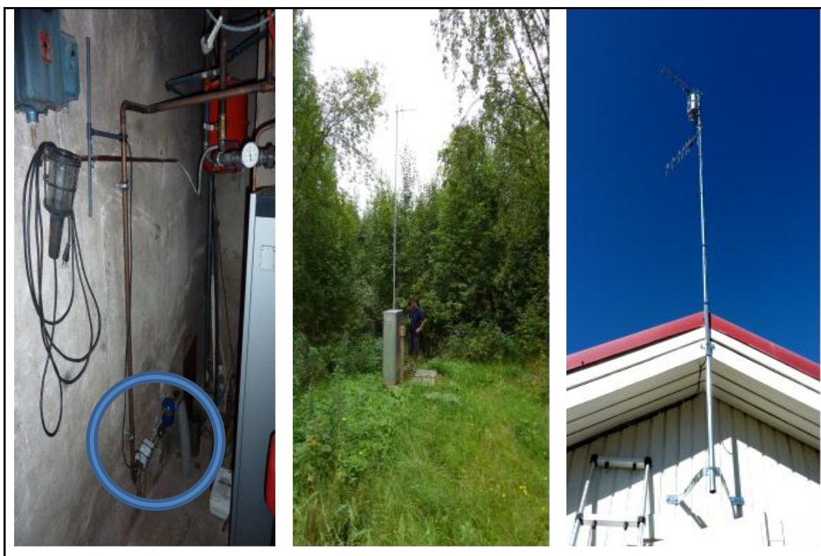
Kuva 4.2.3 Automaattisen mittarinluennan järjestelmä kiinteistössä sekä tukiasemat jätevedenpumppaamon yhteydessä ja kiinteistön huoltorakennuksen yhteydessä
