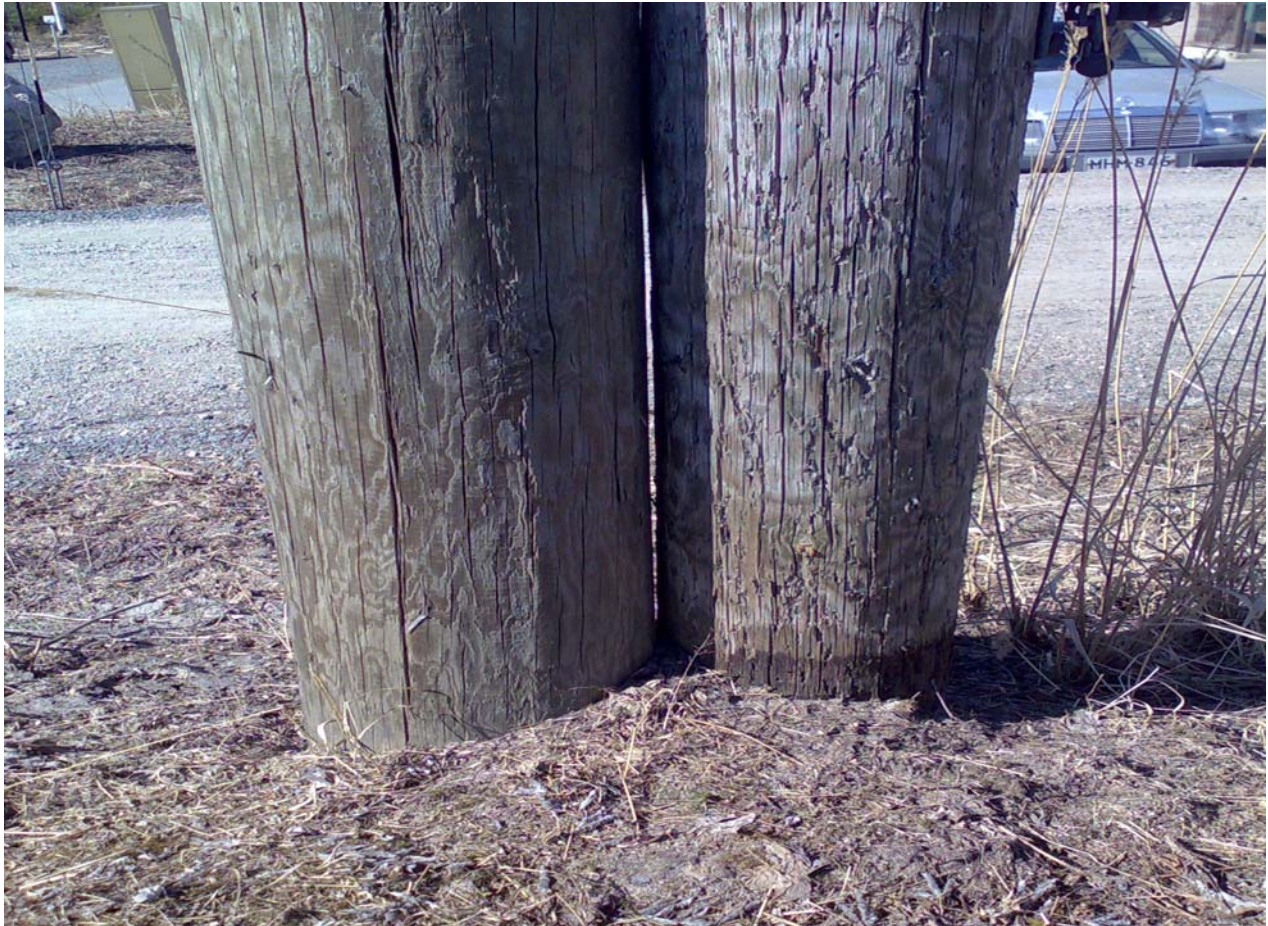
Kuva 9. Kaksi muuntajapylvästä, oikealla 1970-luvun CCA-pylväs, joka on kobrattu vuonna 2001 ja vasemmalla vuonna 1996 kyllästetty CCA-pylväs.
