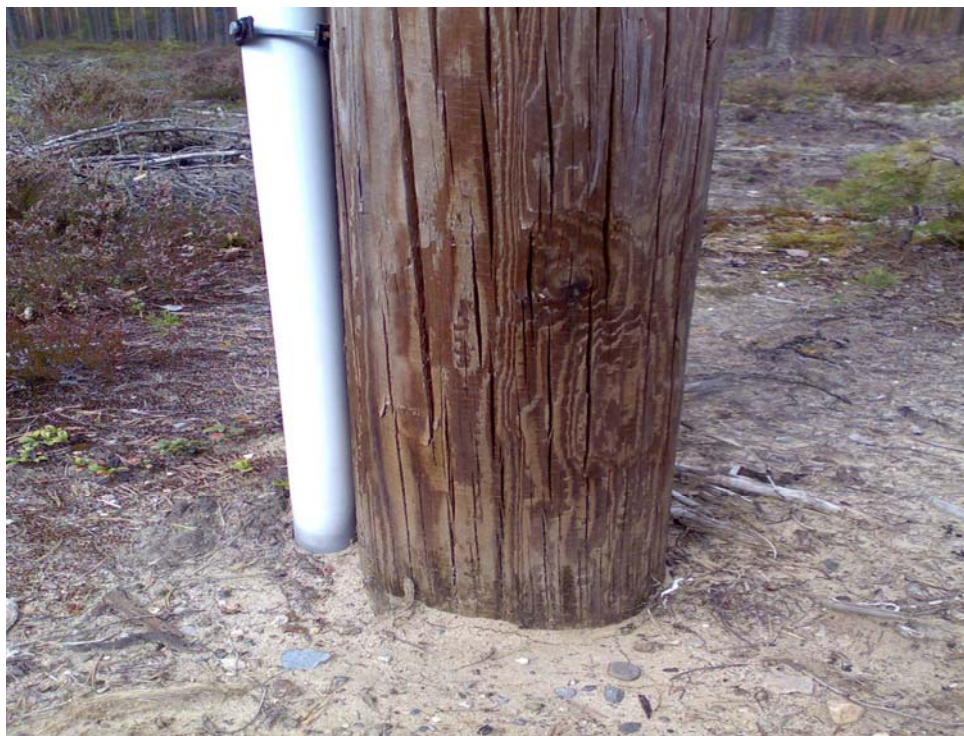
Kuva 21. Lehmon koelinjan Tanalith AB-luokan kyllästetty (13 kg/m 3 ) puupylväs kymmenen vuoden jälkeen – pylväs on pintakerroksesta lahonnut (noin 5mm) ja muuttunut pinnaltaan täysin ruskeaksi.
