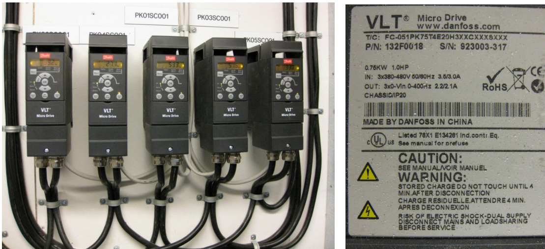
Kuva 6.16. Kerrostalon ilmanvaihdon taajuusmuuttajat ja yhden taajuusmuuttajan tyyppikilpi.
