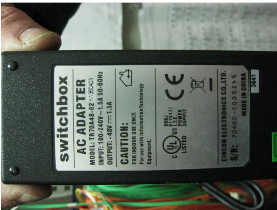
Kuva 6.11. PLC-luentaan häiriöitä aiheuttanut Ethernet-reitittimen teholähde.
