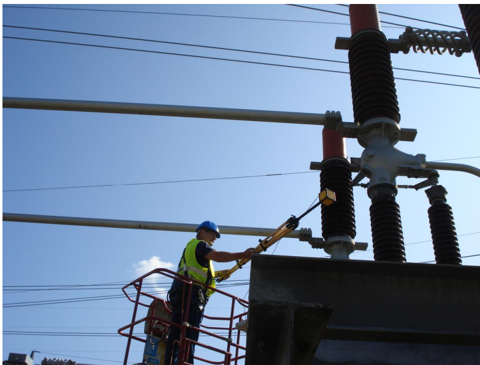
Kuva 5.22 Esimerkki mittauksesta työpisteestä ”katkaisijan katkaisupään huolto nostokorista” 110 kV sähköasemalla (sähkökenttä 0,3 kV/m).
