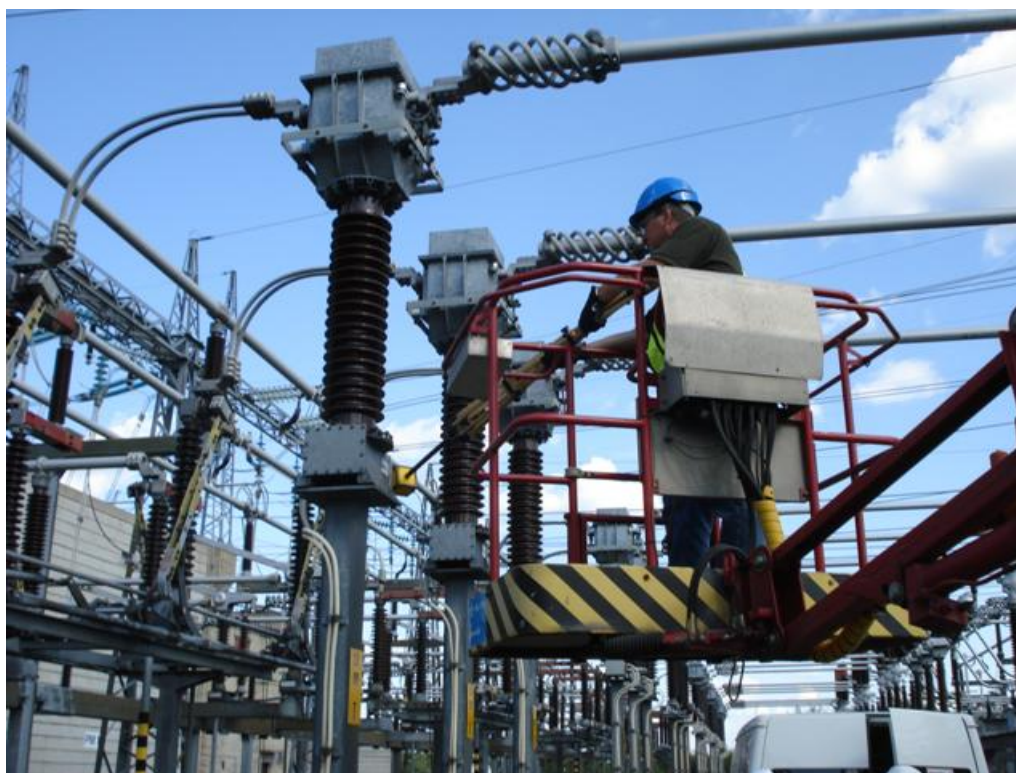
Kuva 5.20 Esimerkki mittauksesta työpisteestä ”virtamuuntajan toisioliitäntäkotelon tarkastus nostokorista” 110 kV sähköasemalla (sähkökenttä 0,5 kV/m).
