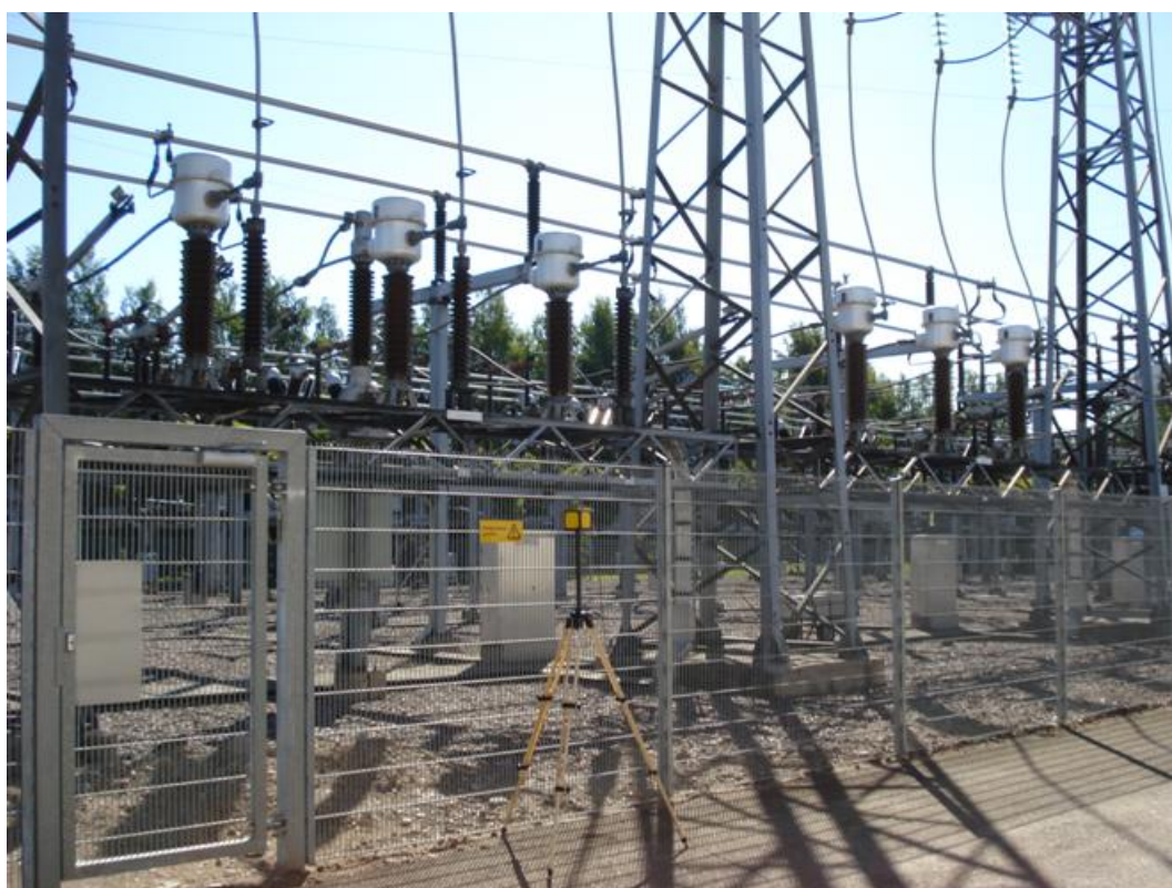
Kuva 5.11 Esimerkki mittauksesta työpisteestä ”käveleminen sähköaseman kentän aidan ulkopuolella” 110 kV sähköasemalla (sähkökenttä 0,5 kV/m, mittauskorkeus 1,7 m).
