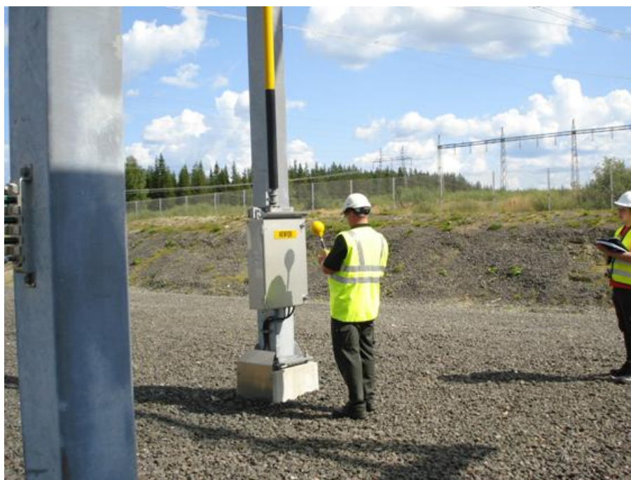
Kuva 5.7 Esimerkki mittauksesta työpisteestä ” maadoituskytkimen ohjaimen tarkastus maan tasolta” 110 kV sähköasemalla (magneettikenttä 3,5 \mu T, 3,0 %, mittauskorkeus n. 1,7 m).
