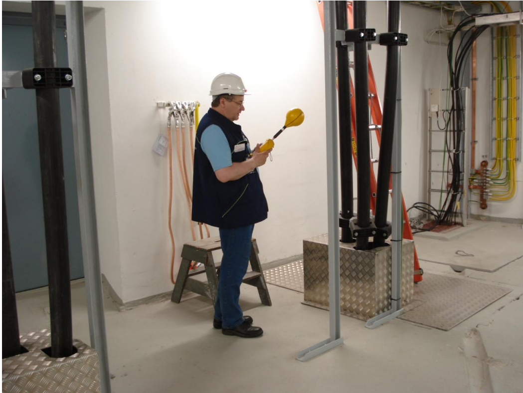
Kuva 5.28 Esimerkki mittauksesta työpisteestä ”GIS -laitoksen kaapelitilassa kävely” 110 kV sähköasemalla (magneettikenttä 25 \mu T, korkeus 1,7 m).
