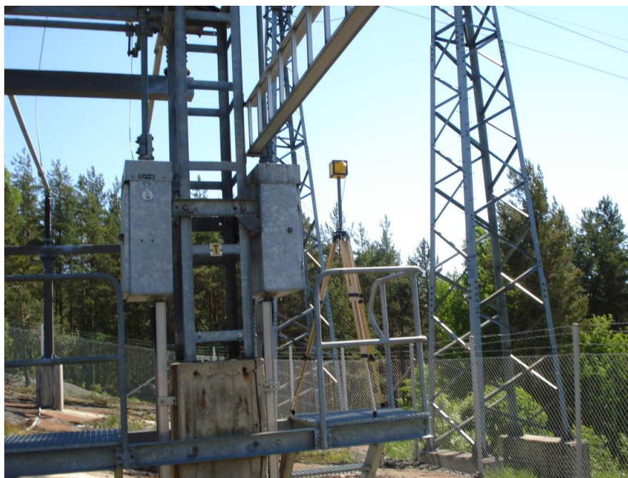
Kuva 5.14 Esimerkki mittauksesta työpisteestä ”erottimen paikallisohjaus hoitotasolta” 110 kV sähköasemalla (sähkökenttä 3,6 kV/m, mittauskorkeus 1,7 m).
