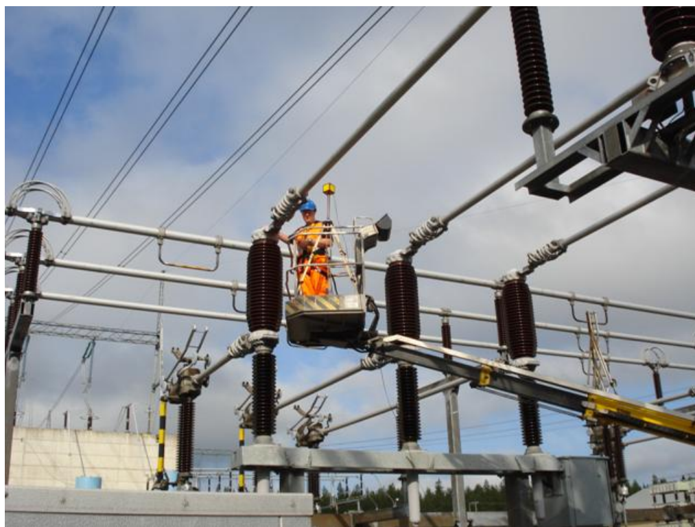
Kuva 5.21 Esimerkki mittauksesta työpisteestä ”katkaisijan katkaisupään huolto nostokorista” 110 kV sähköasemalla (sähkökenttä 2,7 kV/m).
