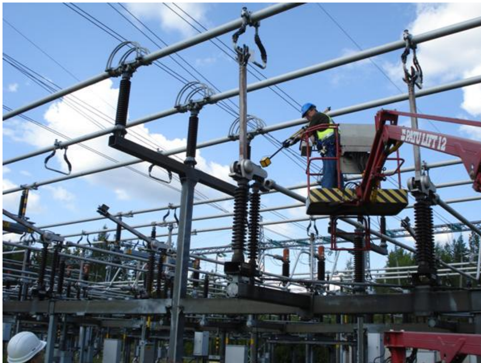
Kuva 5.18 Esimerkki mittauksesta työpisteestä ”tartuntaerottimen kiskokoskettimen huolto nostokorista” 110 kV sähköasemalla (sähkökenttä 0,06 kV/m).
