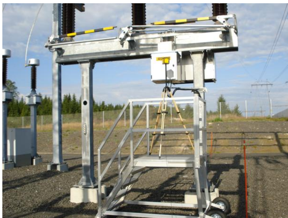
Kuva 5.16 Esimerkki mittauksesta työpisteestä ”maadoituskytkimen ohjaimen tarkastus hoitotasolta” 110 kV sähköasemalla (sähkökenttä 3,1 kV/m, mittauskorkeus 1,7 m).
