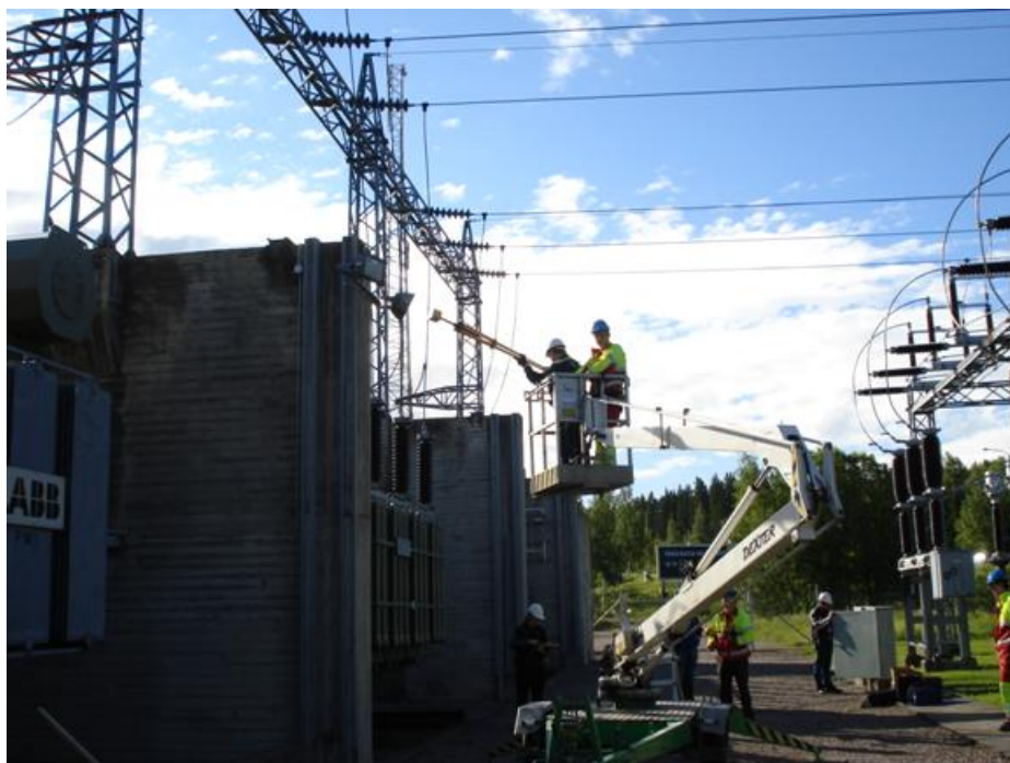
Kuva 1.5. Sähkökenttämittaus nostokorista 110 kV sähköasemalla (mittauksessa sähkökenttä oli 4,9 kV/m ja samassa paikassa magneettikenttä 1,5 \mu\text{T} ).
