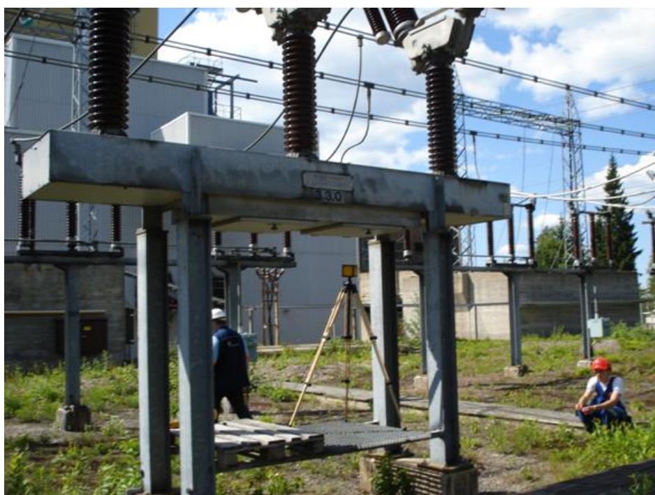
Kuva 5.17 Esimerkki mittauksesta työpisteestä ”katkaisijan ohjaimen tarkastus alapään hoitotasolta” 110 kV sähköasemalla (sähkökenttä 0,6 kV/m, mittauskorkeus 1,4 m, tason korkeus 65 cm).
