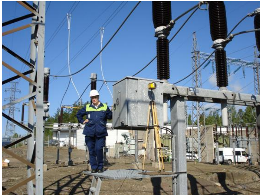
Kuva 1.2 Esimerkki hoitotasomittauksesta 110 kV sähköasemalla (mittauksessa sähkökenttä oli 16,6 kV/m ja samassa paikassa magneettikenttä 21,0 \mu T).
