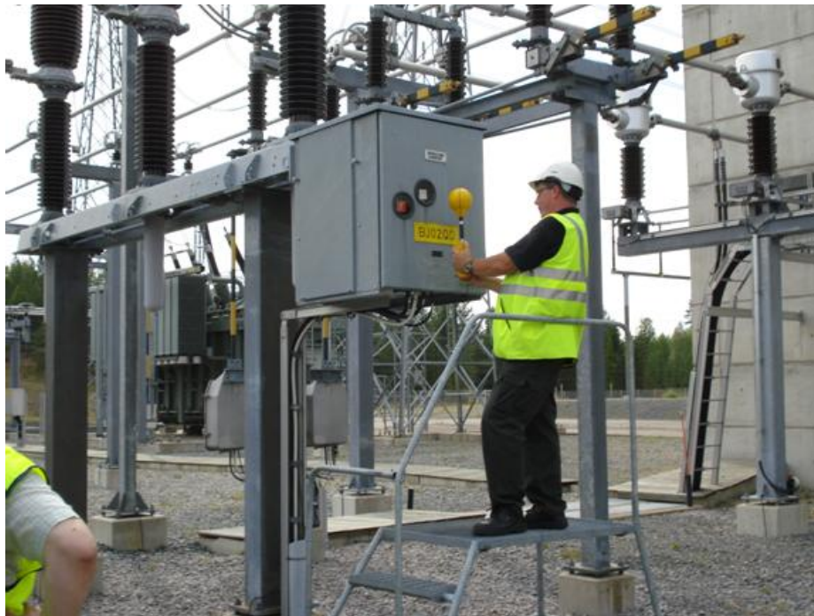
Kuva 5.30 Esimerkki mittauksesta työpisteestä ”reaktorin katkaisijan paikallisohjaus hoitotasolta (20 kV)” 110 kV sähköasemalla (magneettikenttä 97 \mu T, korkeus 1,7 m).
