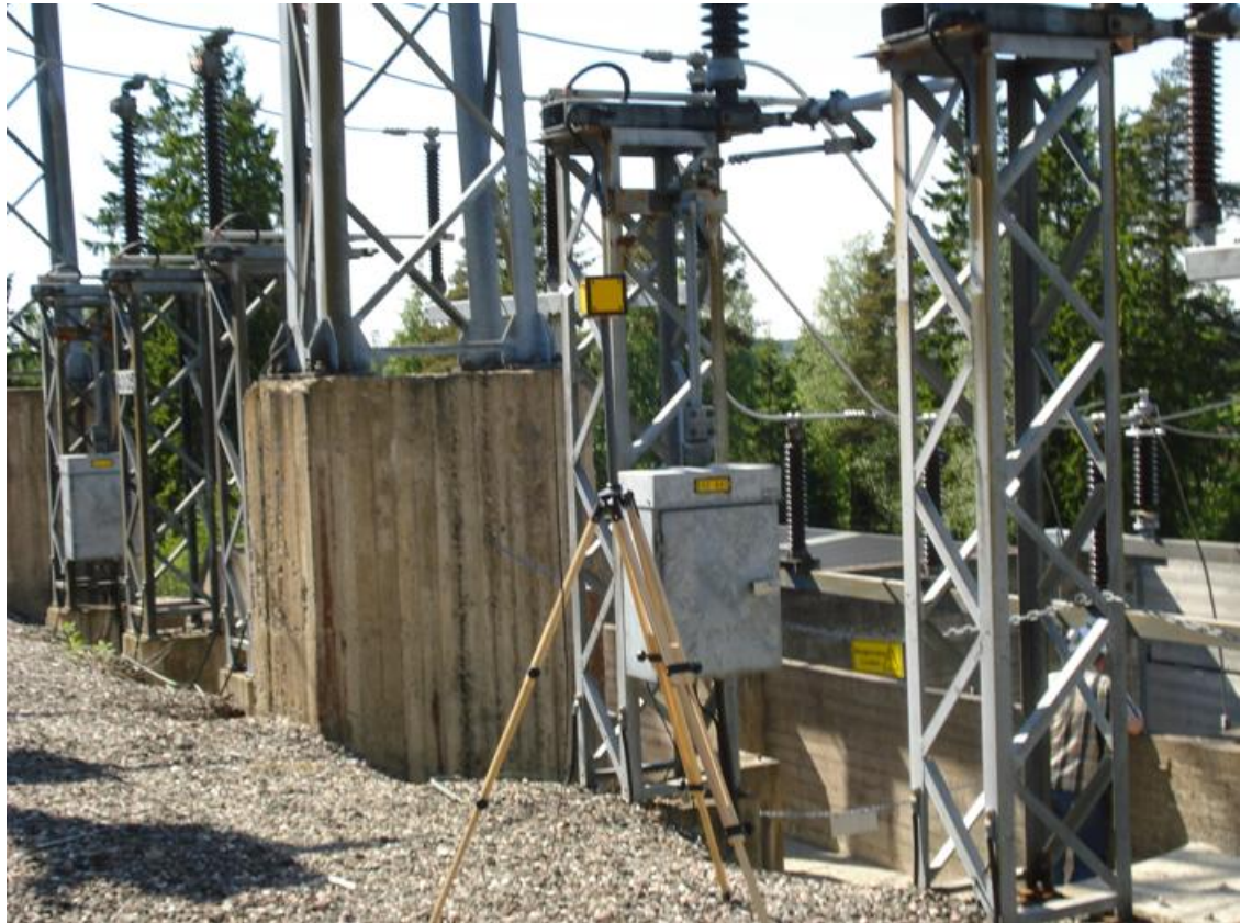
Kuva 5.27 Esimerkki mittauksesta työpisteestä ”päämuuntajan kannen ja läpivientien tarkastus” 110 kV sähköasemalla (sähkökenttä 2,2 kV/m).
