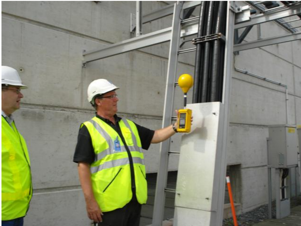
Kuva 5.31 Esimerkki mittauksesta työpisteestä ”kulkeminen reaktorin kaapelien lähellä (20 kV)”. 110 kV sähköasemalla. Mittauksessa magneettikenttä 580 \mu\text{T} (kaapeli 1, kuvassa), magneettikenttä 710 \mu\text{T} (kaapeli 2), magneettikenttä 690 \mu\text{T} (kaapeli 3), korkeus n. 1,8 m arvioitu kuvasta.
