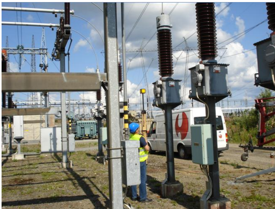
Kuva 5.24 Esimerkki mittauksesta työpisteestä ”jännitemuuntajan toisioliitännäkotelon tarkastusnostokorista” 110 kV sähköasemalla (sähkökenttä 1,4 kV/m).
