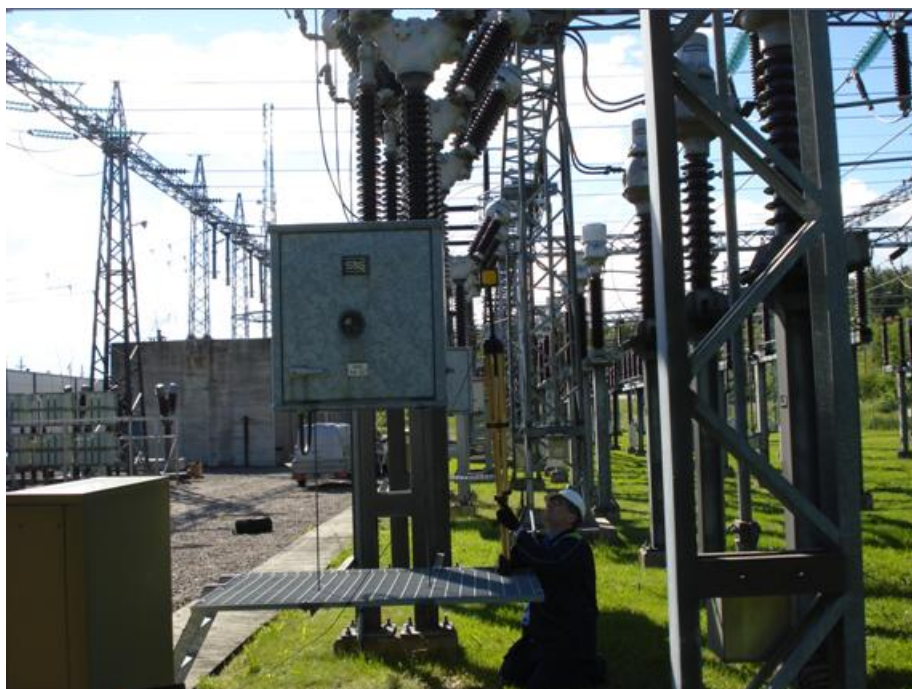
Kuva 1.3 Esimerkki hoitotasomittauksesta 110 kV sähköasemalla (mittauksessa sähkökenttä oli 14,2 kV/m ja samassa paikassa magneettikenttä 0,4 \mu T).
