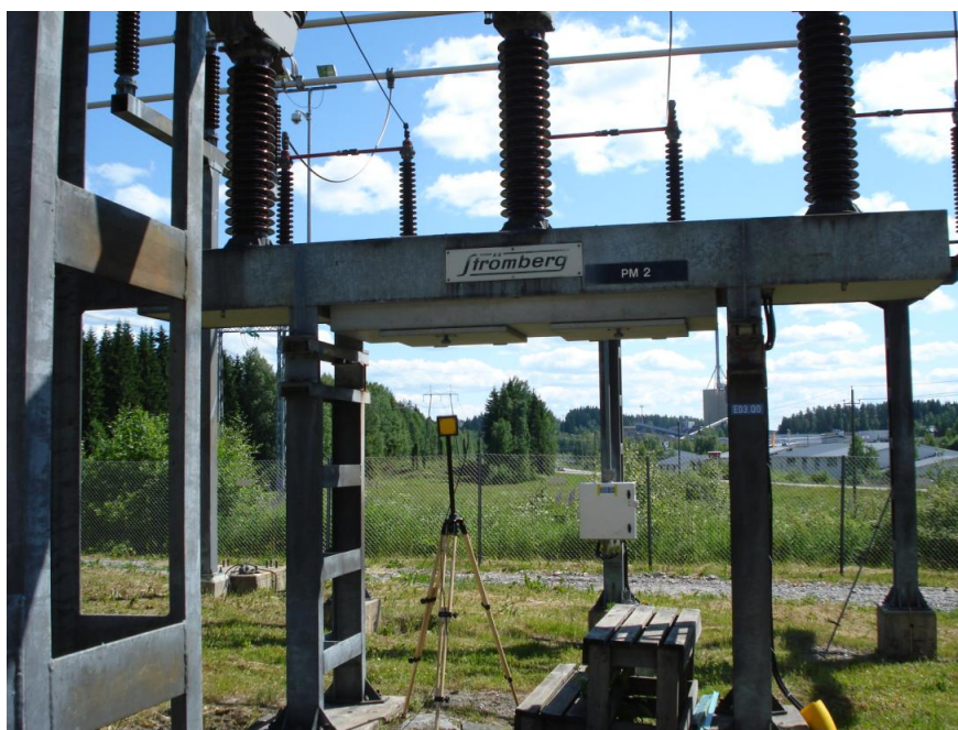
Kuva 5.10 Esimerkki mittauksesta työpisteestä ” katkaisijan ohjaimen tarkastus alapään maan tasolta”110 kV sähköasemalla (sähkökenttä 0,5 kV/m, mittauskorkeus 1,7 m).
