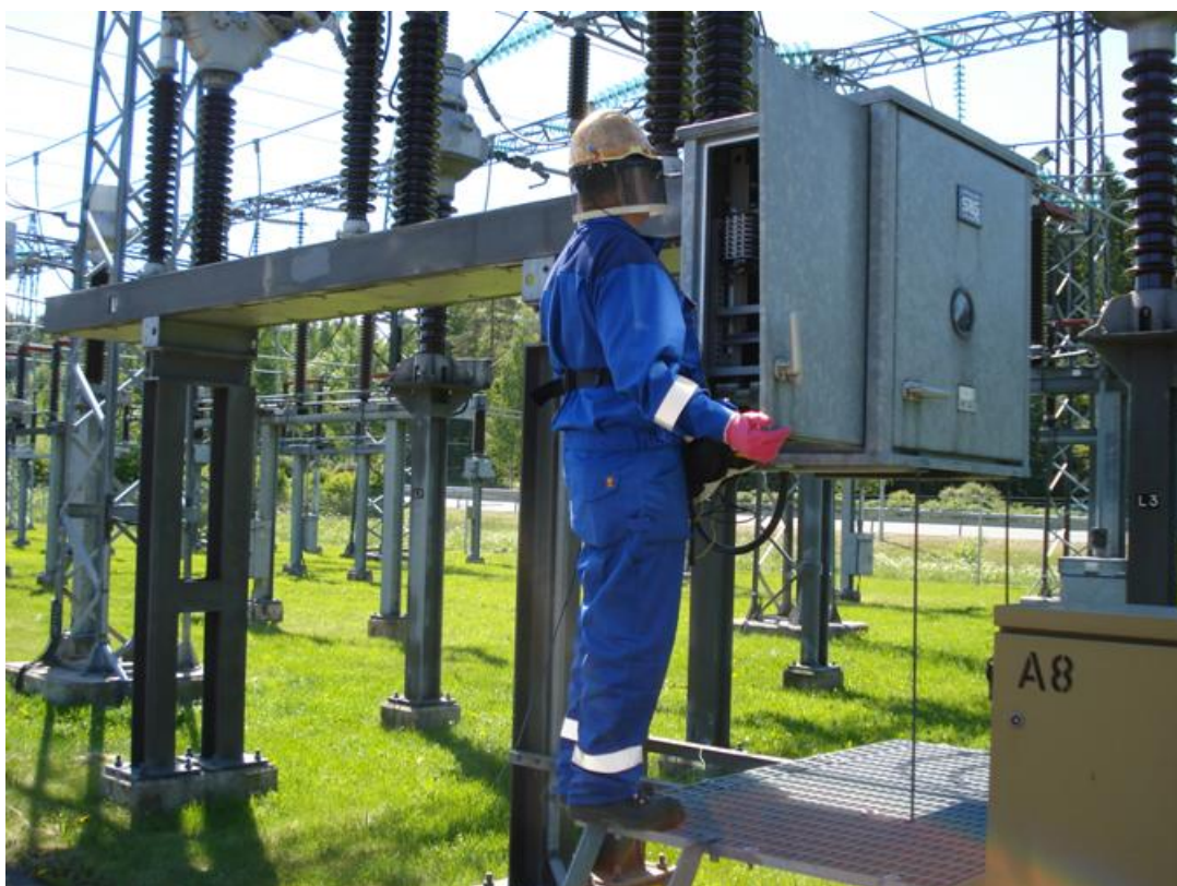
Kuva 5.32 Esimerkki kypärämittauksesta työtehtävässä ”katkaisijan ohjaimen tarkastus hoitotasolta” 110 kV sähköasemalla.
