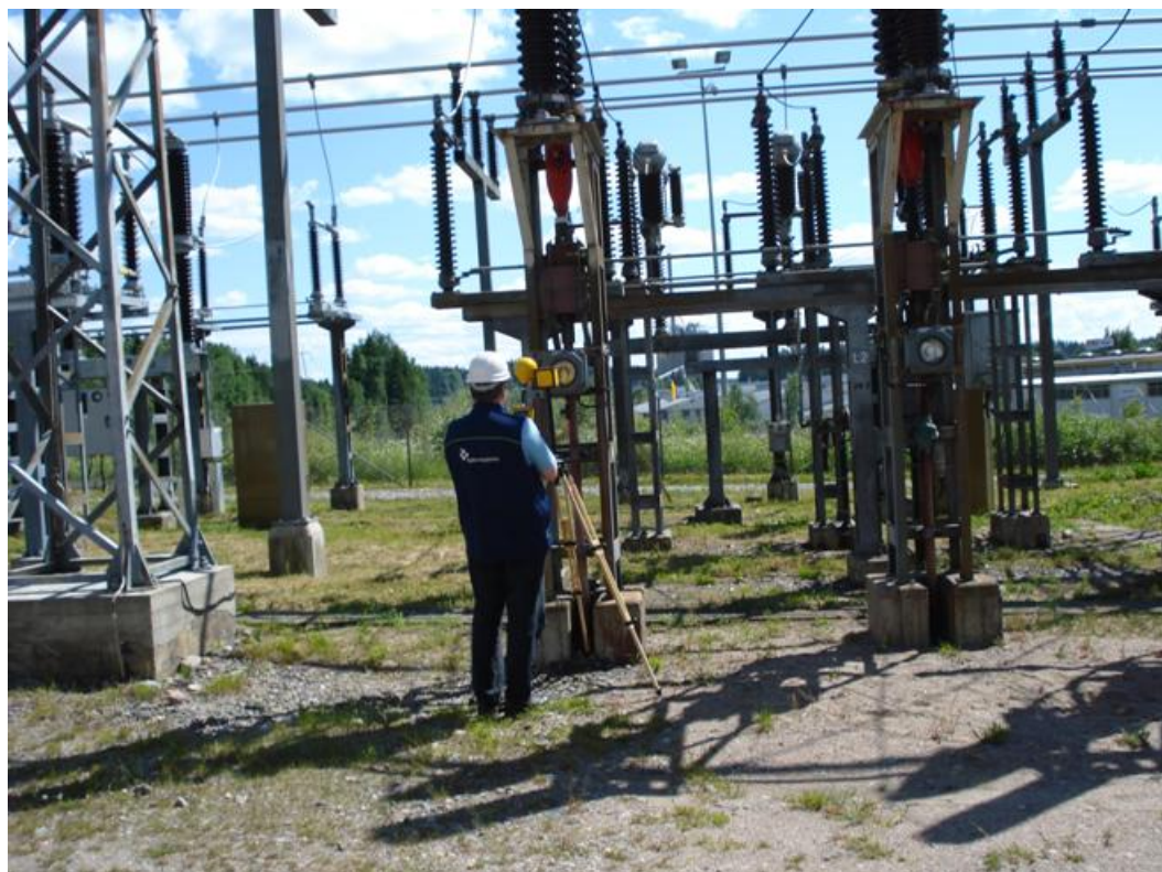
Kuva 5.9 Esimerkki mittauksesta työpisteestä ”kaapelipäätteen öljynpainemittarin lukeminen maan tasolta” 110 kV sähköasemalla (magneettikenttä 12,2 \mu\text{T} , mittauskorkeus 1,7 m).
