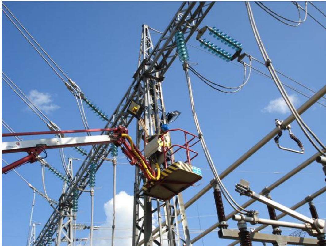
Kuva 5.25 Esimerkki mittauksesta työpisteestä ”valaisimen kunnossapito nostokorista” 110 kV sähköasemalla (sähkökenttä 7,8 kV/m).
