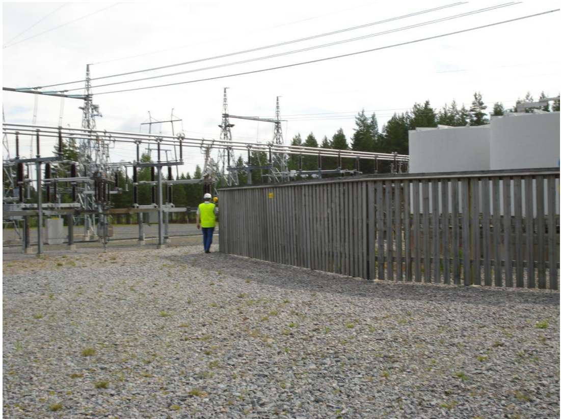
Kuva 5.29 Esimerkki mittauksesta työpisteestä ”kävely reaktorin aidan vieressä” 110 kV sähköasemalla (magneettikenttä 170-260 \mu\text{T} kävellessä korkeus 1,7 m).
