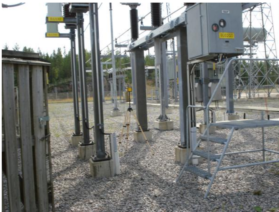
Kuva 5.12 Kuva mittauksesta työpisteessä ”kulkeminen 20 kV kytkinlaitoksella” (sähkökenttä 0,2 kV/m, mittauskorkeus 1,7 m).
