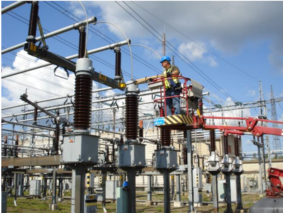
Kuva 5.23 Esi merkki mittauksesta työpisteestä ”jännitemuuntajan ensiöliitännän tarkastus nostokorista” 110 kV sähköasemalla (sähkökenttä 01,6 kV/m).
