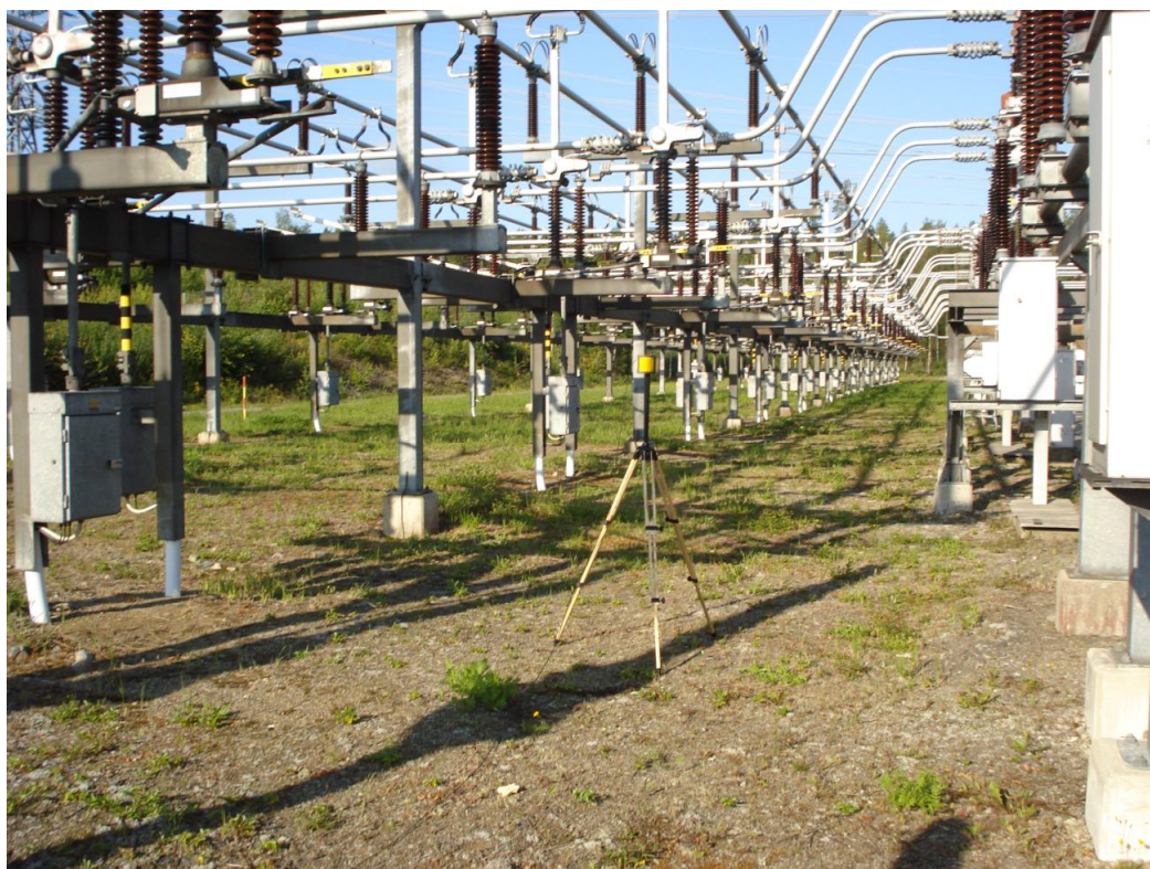
Kuva 5.4 Esimerkki sähkökenttämittauksesta työpisteestä ”kulkeminen 110 kV kytkinlaitoksella” 110 kV sähköasemalla (sähkökenttä 2,7 kV/m, mittauskorkeus 1,7 m).
