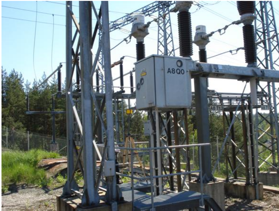
Kuva 5.15. Esimerkki mittauksesta työpisteestä ”katkaisijan ohjaimen tarkastus hoitotasolta” 110 kV sähköasemalla (sähkökenttä 3,6 kV/m, mittauskorkeus 1,7 m).
